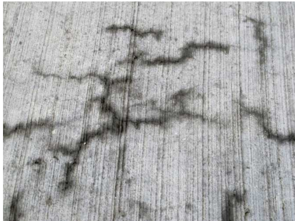
Bild 10 Frührissbildung in der Fahrbahnplatte eines Parkdecks
